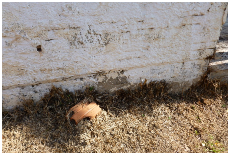
Figura 3: Viga de fundação separada da alvenaria em função da movimentação das fundações.
