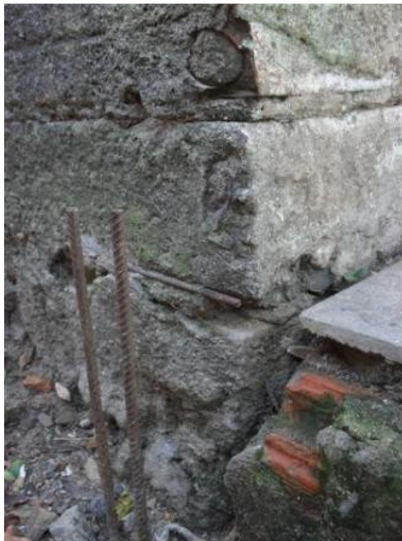
Figura 7: Viga de fundação com ferragem exposta.
