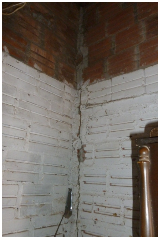
Figura 1: Fissura vertical na parte interna da residência
