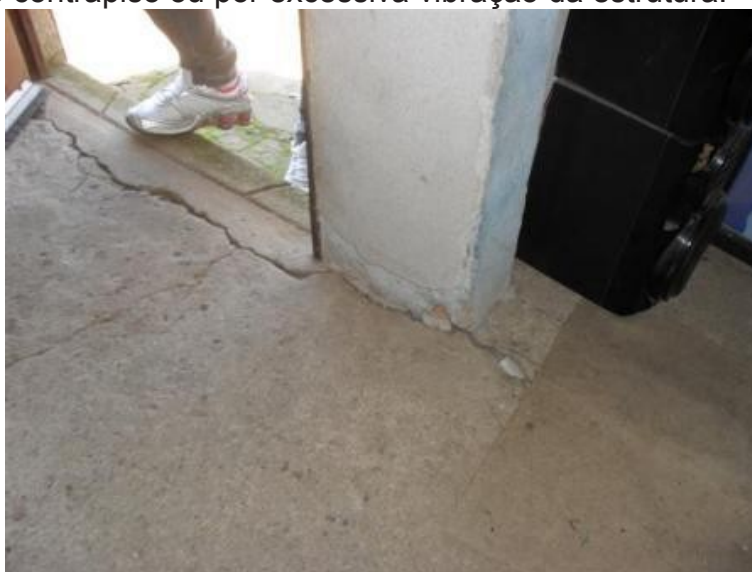
Figura 8: Movimentação do contrapiso.
