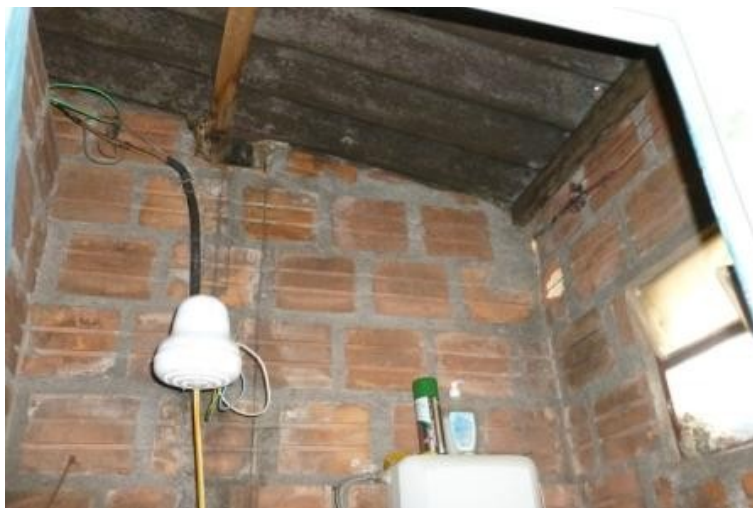
Figura 5: Estrutura da cobertura demonstrando sinais de infiltração
