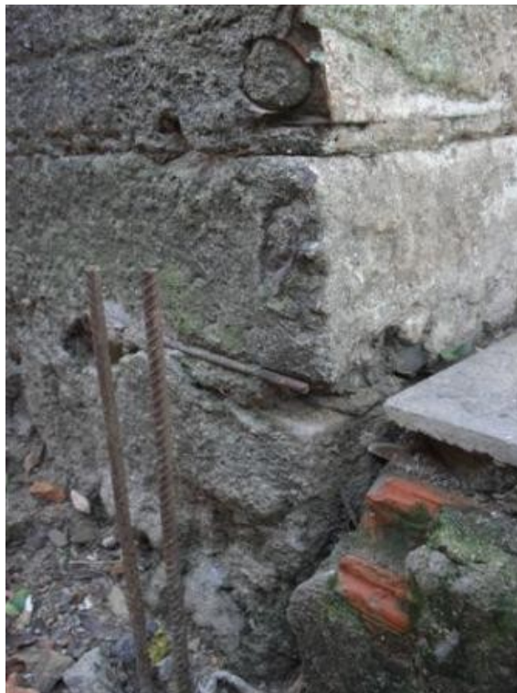
Figura 7: Viga de fundação com ferragem exposta.
