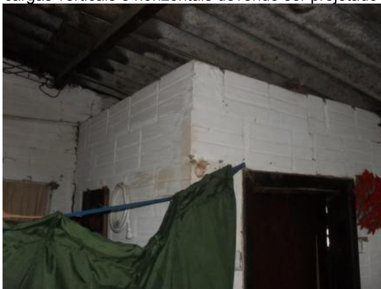
Figura 6: Ausência de viga de amarração e verga no vão da porta ainda original.
