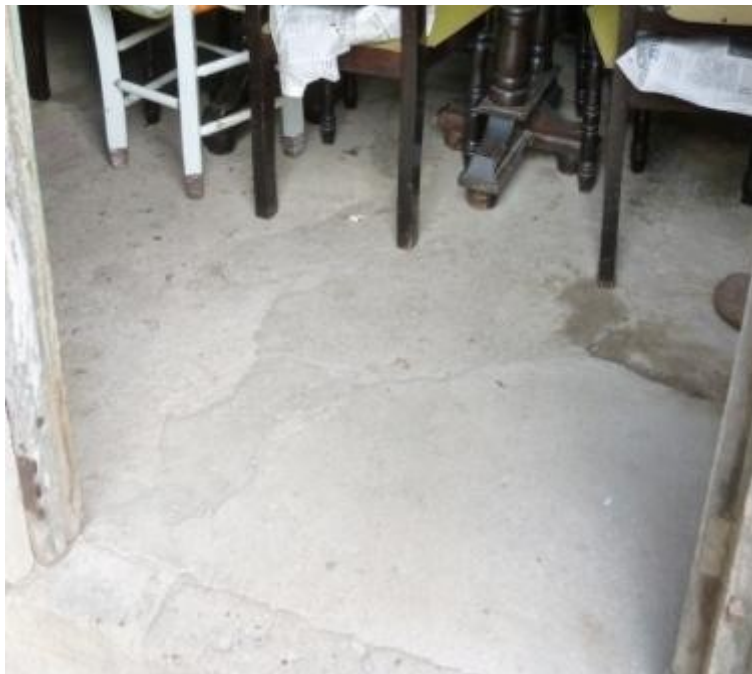
Figura 9: Contrapiso em péssimas condições apesar dos enchimentos feitos.
