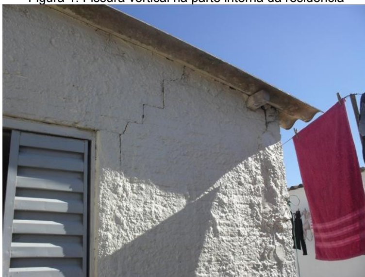
Figura 2: Fissura na parede externa da residência
