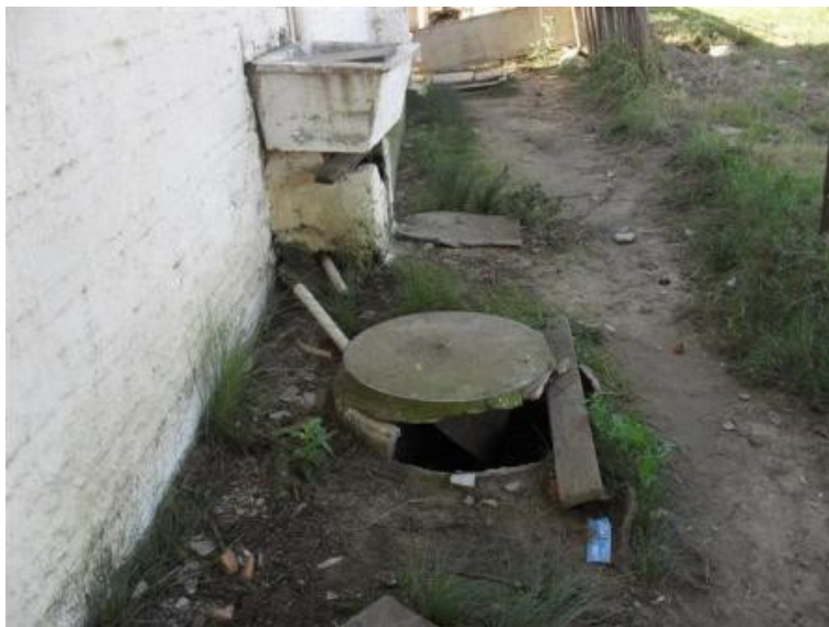
Figura 11: Fossa séptica quebrada, deixando ao ambiente insalubre.
