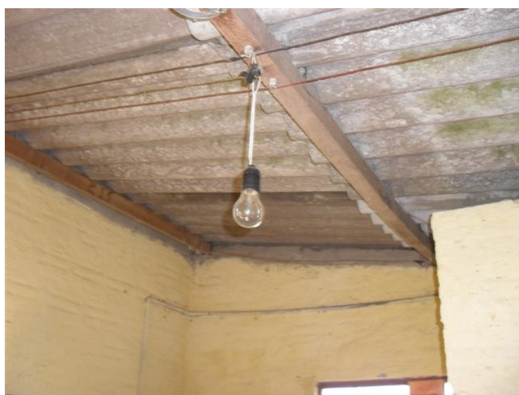
Figura 4: Madeiramento do telhado superdimensionado, vão muito grande entre caibros.
