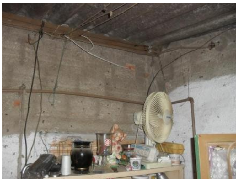
Figura 10: Instalações elétricas aparentes, causando riscos eminentes.
